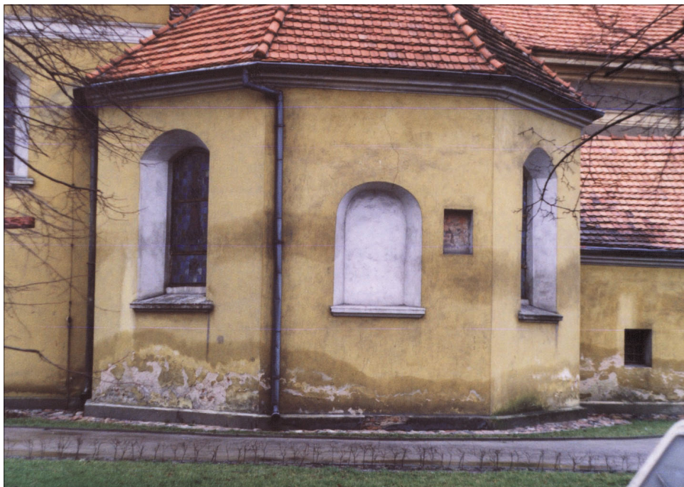
Zawilgocone mury kaplicy przed remontem
