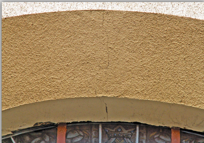
Pęknięte nadproże okienne
